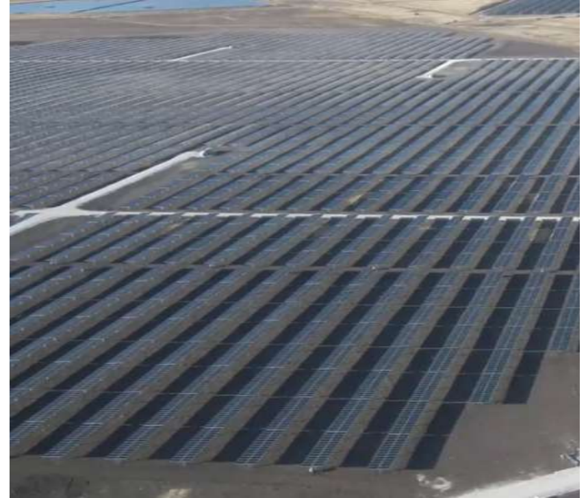
Project Séneca, a 50 MW PV in Palma del Río, Córdoba
