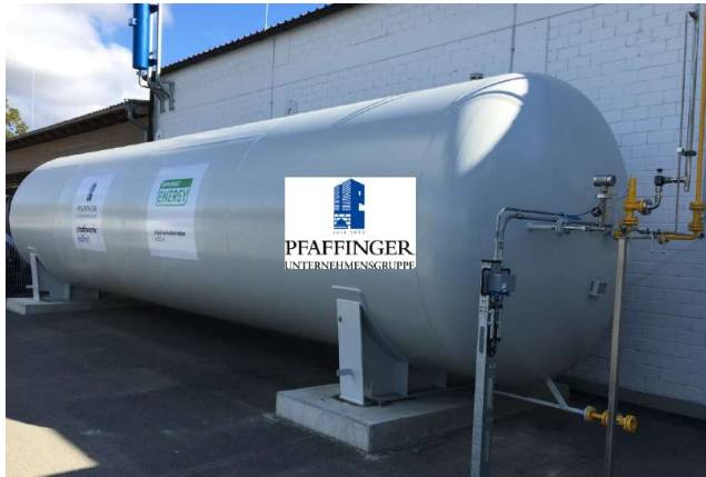
Tanque de hidrógeno
